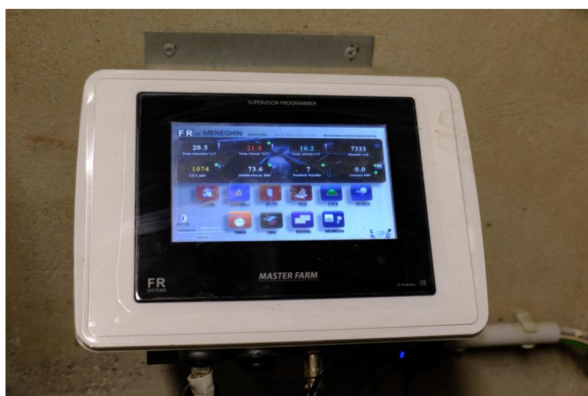
Figura 21 Centralina per il monitoraggio della temperatura e gas ambientali.
