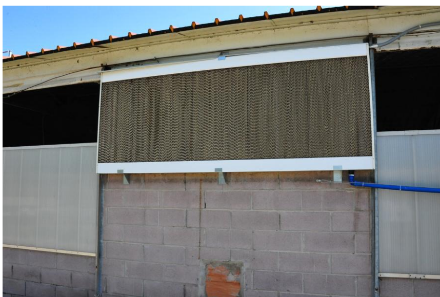
Figura 20 Impianto di raffreddamento (cooling).
