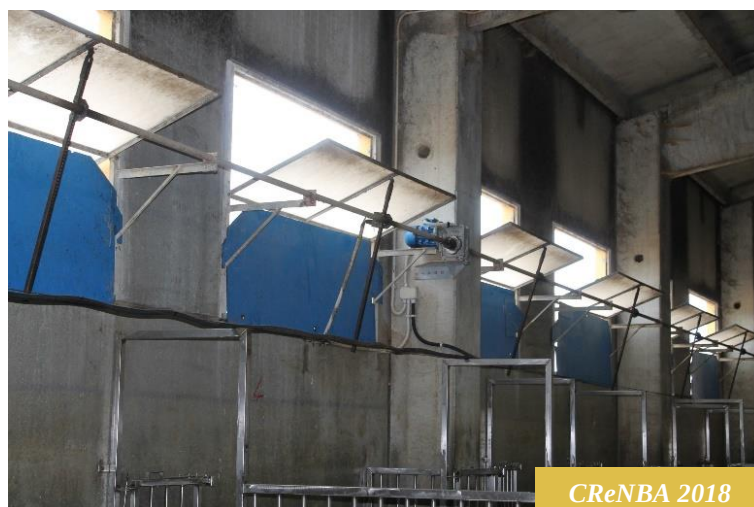
Figura 43 – Condizioni microclimatiche idonee per gli animali: es. ventilazione naturale garantita da finestre ad apertura/chiusura automatica.
