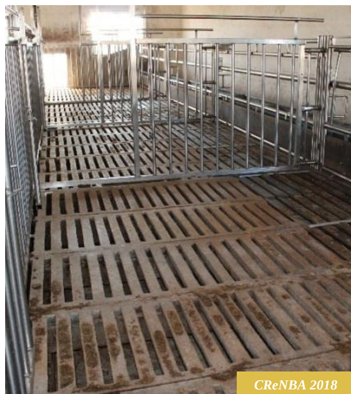
Figura 35 - Fessurato in cemento (non idoneo).
